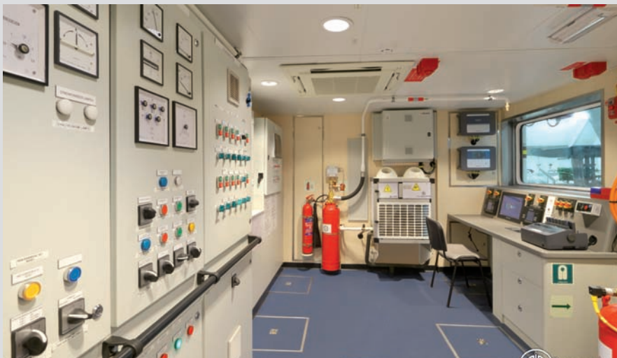
> Sala control de cámara de máquinas en los cuadros eléctricos de Insyte.
