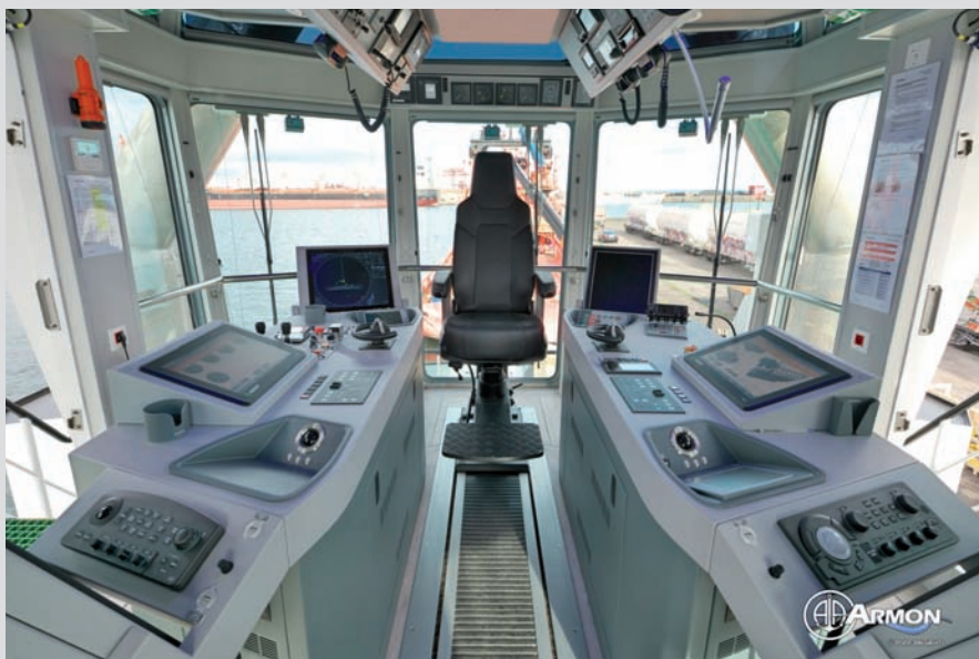
> Equipos de puente, suministrados por JRC.
