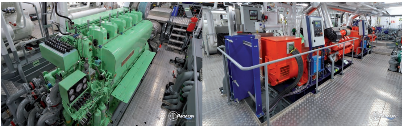
> Dos imágenes de la sala de máquinas del “Destiny” con el motor principal Yanmar y los grupos generadores Scania.
