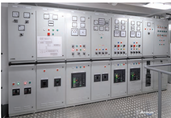
> Cuadros eléctricos de Insyte Instalaciones.
