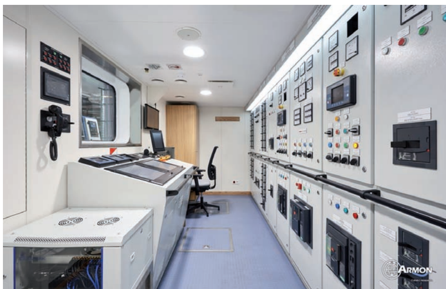
➤ Cuadros eléctricos de Insyte Instalaciones.
